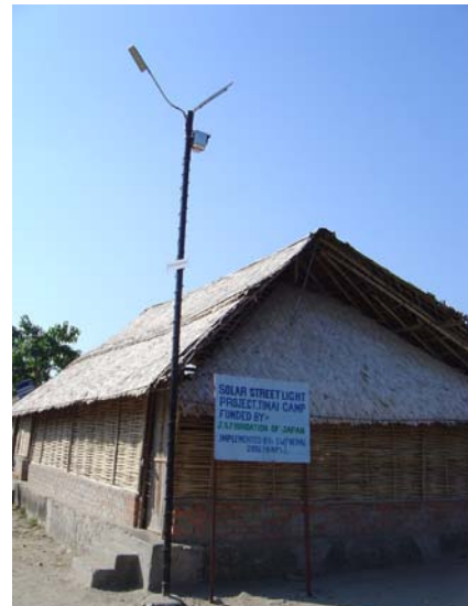
キャンプ内に設置された太陽光発電街灯
